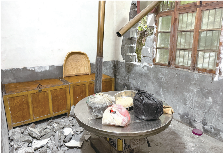
石块击穿客厅墙体，造成房屋受损。
