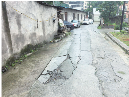
改造前的路面，坑坑洼洼，存在安全隐患。
