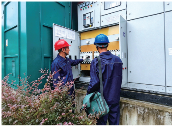
刘伟(左)和同事检查环网柜运行情况。
