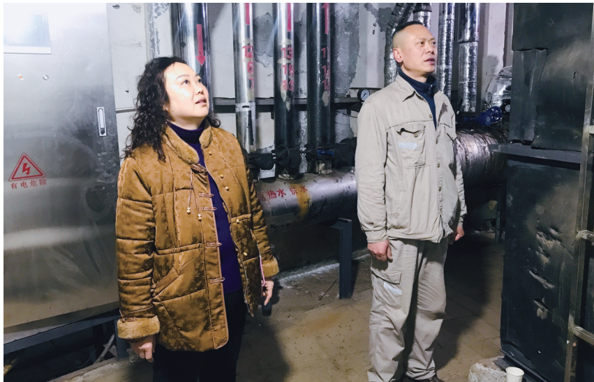
供暖结束后,陈耀玲(左)在小区供暖房查看设备设施情况。
