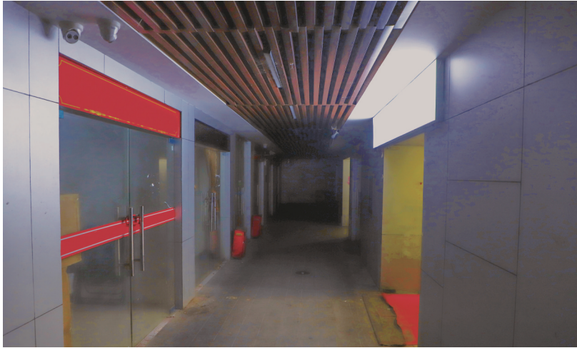
地下通道顶部数盏照明灯均不亮。
