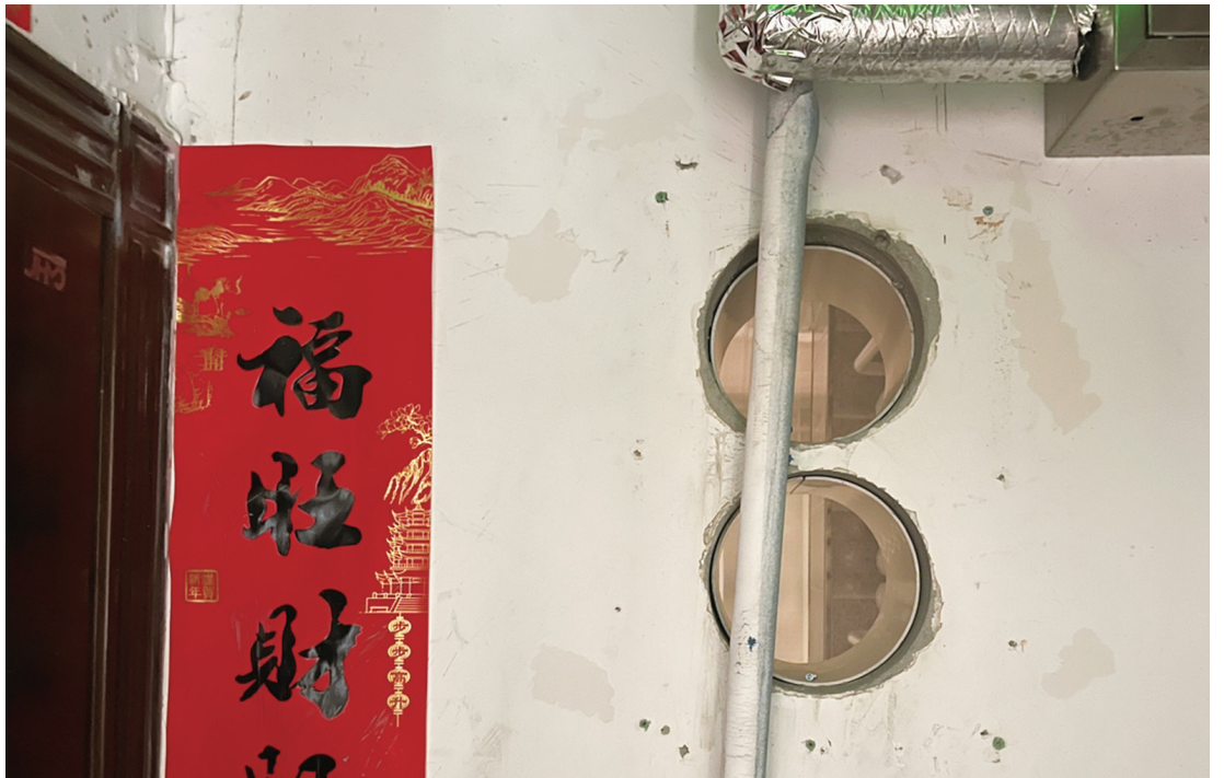
公共墙体上凿开的两个孔洞,紧挨着居民大门。
