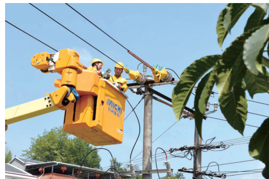
国网十堰供电公司员工保障电网负荷高峰。
