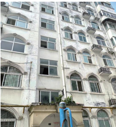
改造前,小区外墙墙皮脱落。
