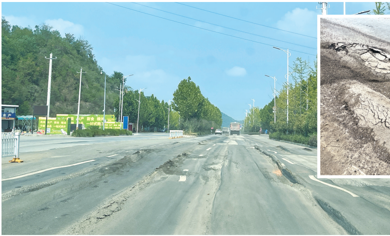
数百米长的路面上坑坑洼洼,随处可见一道又一道深槽。
