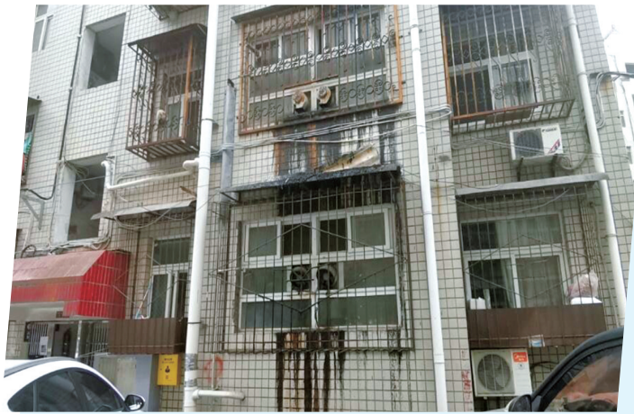
东安小区居民楼厨房外油污明显。
