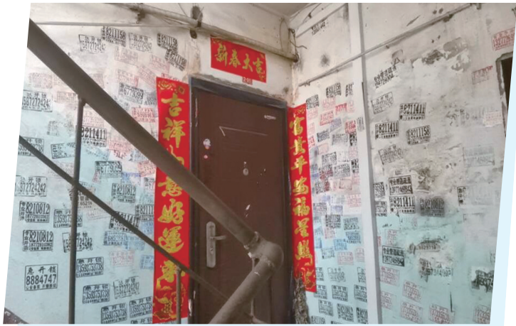
东岳南山小区56栋楼道内墙上印满了小广告。
