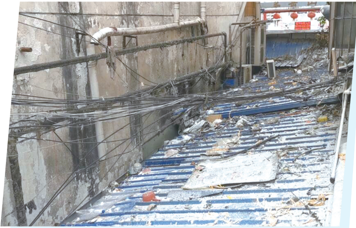
东风(十堰)设备安装有限公司楼栋东侧房顶上满是垃圾。
