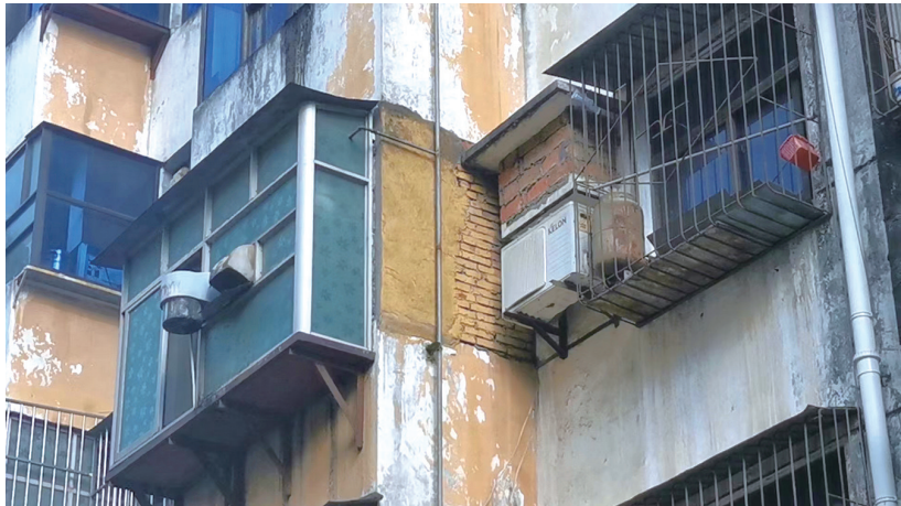
东风设备制造厂小区35号楼外墙脏污,露出墙砖。
