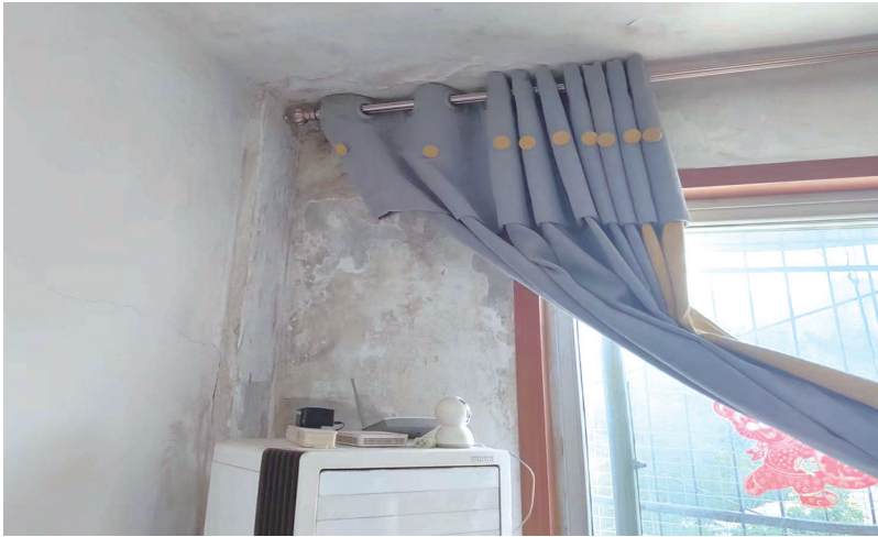
由于长期漏水,墙皮已经脱落发霉。
