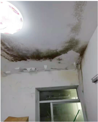
王先生家的天花板浸水严重。
