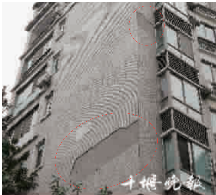
墙面瓷砖已经脱落不少。
