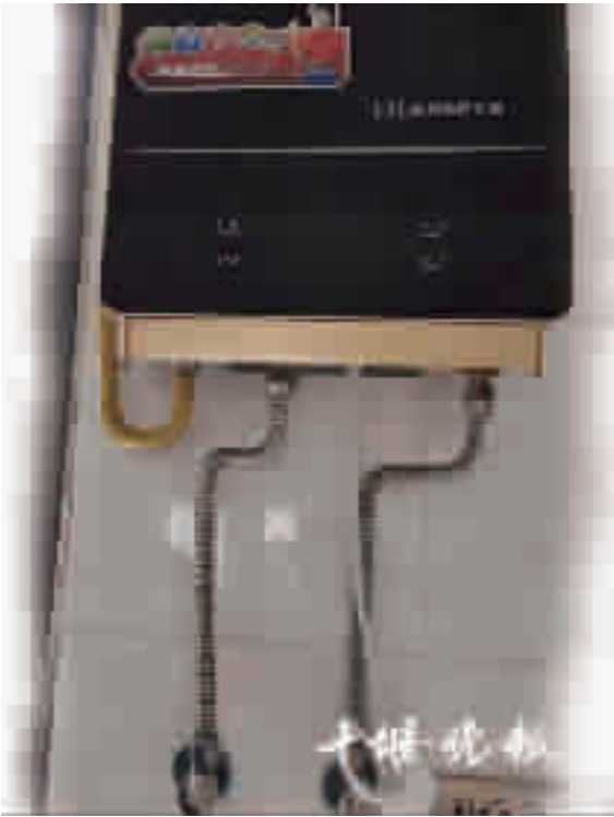
张先生家热水器的黄色燃气管接到了出水口上。
