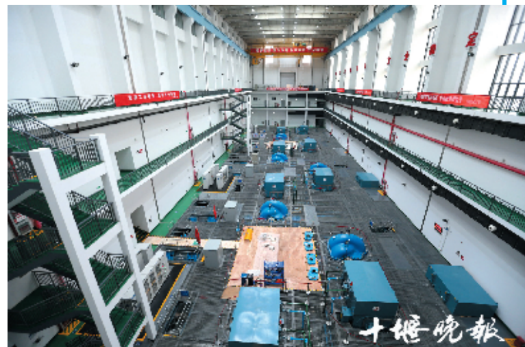
泵站厂房内的8台世界上最先进的单级双吸卧式离心泵。
