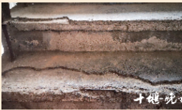
怡心小区楼道内破损的台阶。
