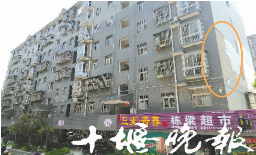
目前,该小区4号楼一侧的瓷砖脱落面积约有7平方米。
