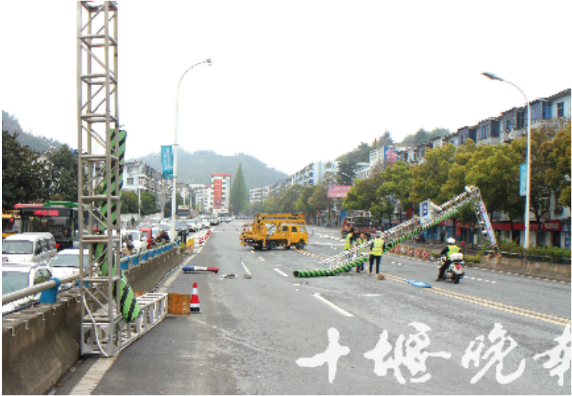
限高架被拦腰撞断,工作人员正在抢修。
