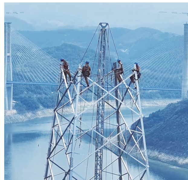
西十高铁箭流铺牵引站220kv外部供电工程首基杆塔组立施工现场。
