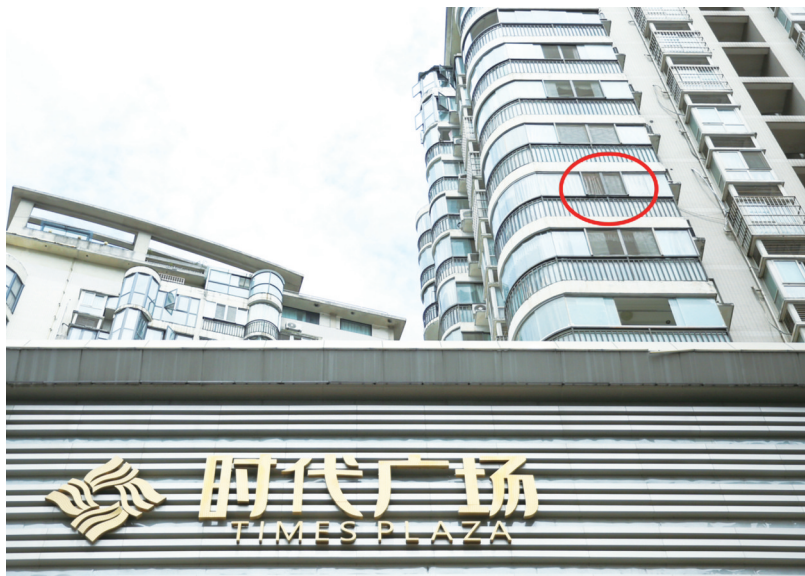
9楼一住户家的窗户玻璃突然爆裂掉落。
