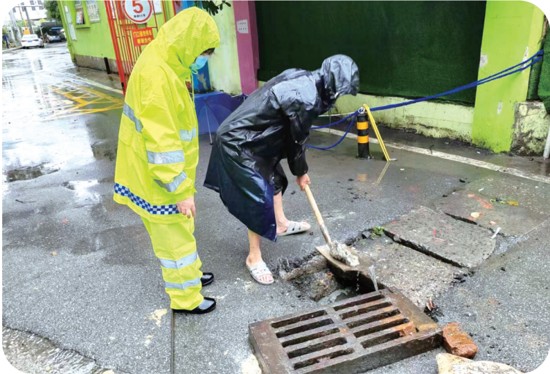
下雨排水沟堵塞,网格员急忙疏通。
