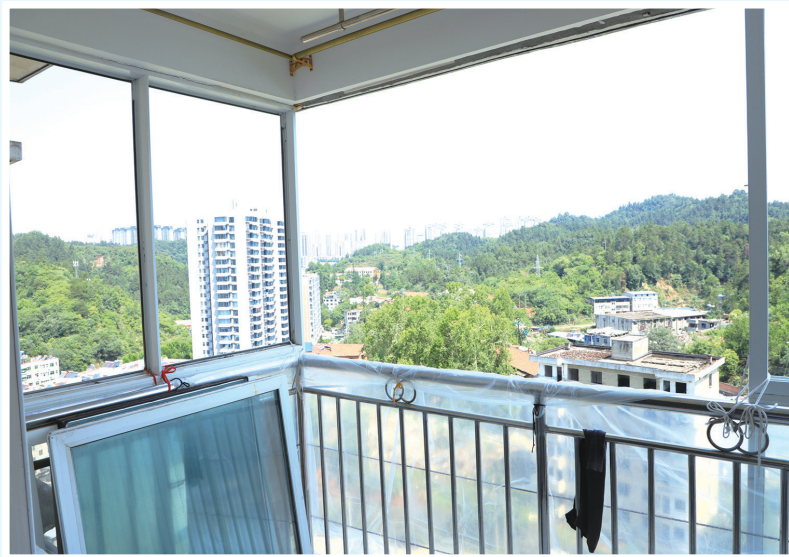
一户居民家的落地窗已脱落。
