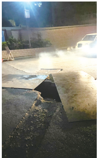
两块钢板松动露出大坑。
