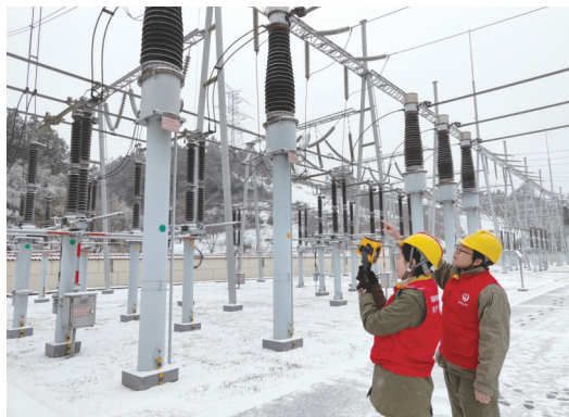
变电运检分公司运维人员对重要变电站及重要供电设备开展红外测温,监测分析设备状态。
