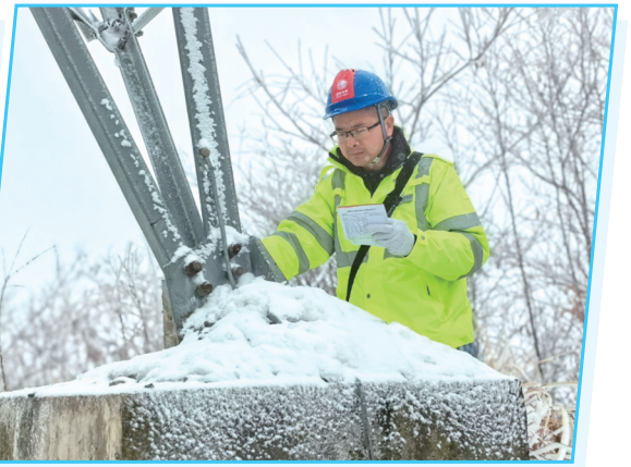
国网十堰供电公司工作人员对110kV丰葛线进行特巡。
