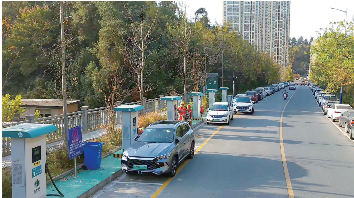
国网黄石路充电站共建有 6 个直流充电桩,配有 6 把充电枪,能满足附近小区居民的充电需求。
