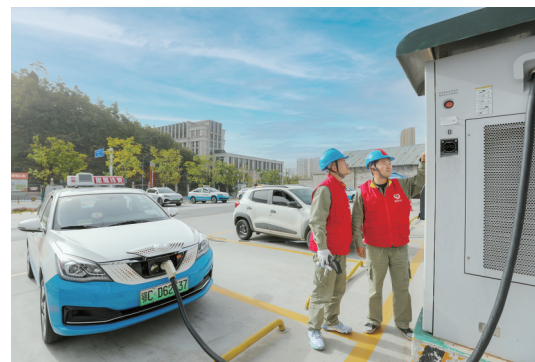
工作人员在林荫大道友德公馆充电站检查充电设备。
