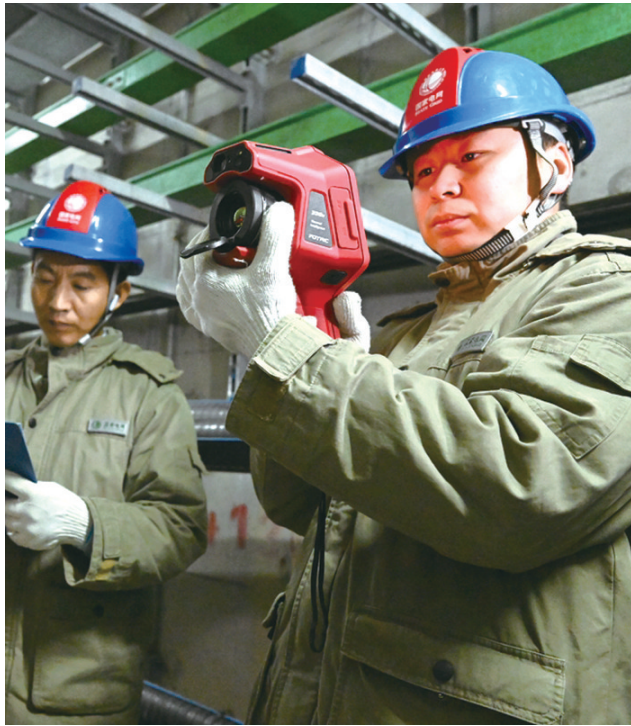
宋程(右)和同事在地下管廊对电缆中间的接头进行红外检测和接地环流检测,确保设备安全可靠运行。
