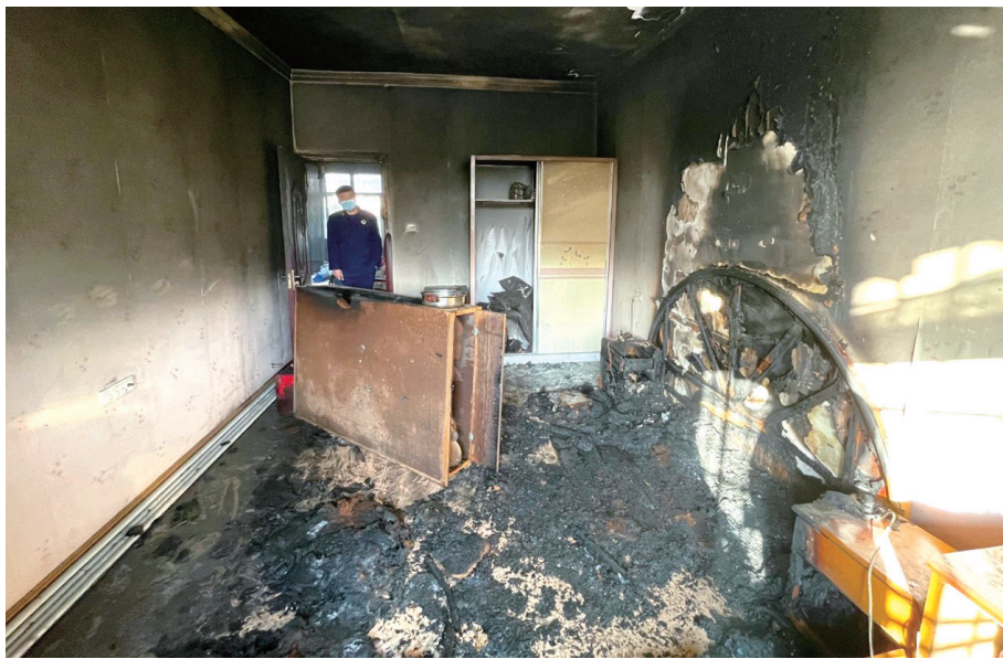
张湾区一位居民因“超龄”使用电热毯引发火灾,导致卧室床铺被烧毁,屋内一片狼藉。
