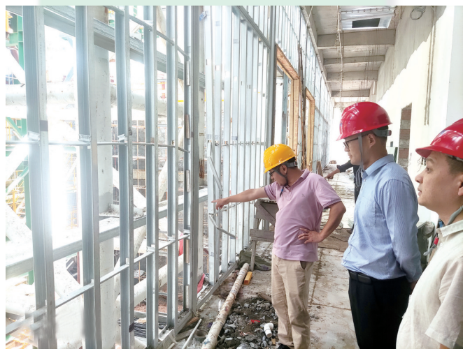
工行十堰分行领导带队走访丹江口海创绿能环境能源科技有限责任公司丹江口生活垃圾焚烧发电项目施工现场。
