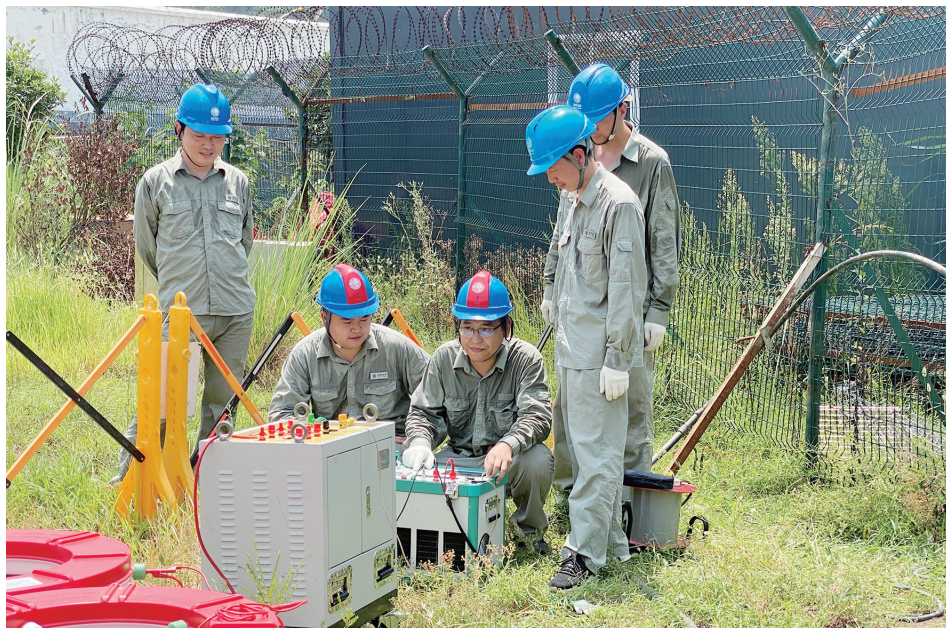
巨能配电公司修试计量班对武当山机场各区域电气设备和线路进行检修。
