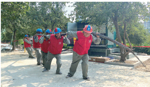
8月18日,巨能配电公司电气二班正在抓紧完成汉江师范学院专配房敷设电缆任务。
