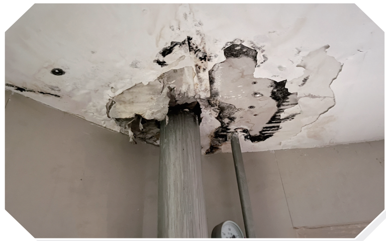
因长期漏水,楼顶发霉掉皮。
