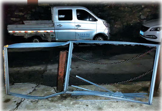
掉落的窗户只剩下框架,已经严重变形。
