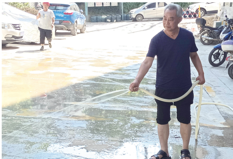
西城佳苑小区正在开展老旧小区改造,何同林每天到现场洒水降尘。
