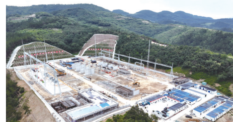
电站投运后将将为十堰电网提供500千伏电源“双保险”。
