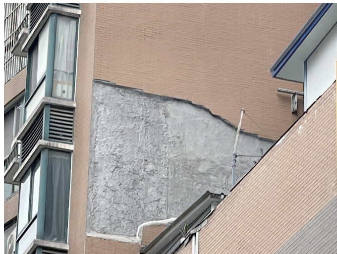
杨先生所在小区外墙瓷砖脱落情况时有发生。
