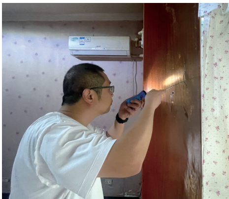
居民家中窗框被白蚁咬空，一摞一个洞。
