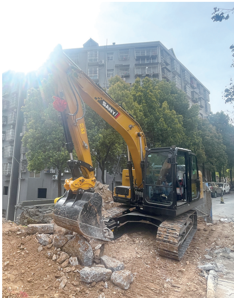
郧阳区郧阳东路片区老旧小区改造现场,机械轰鸣声不断。
