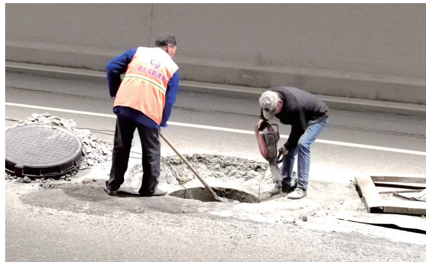
施工方通过一系列措施,避免再次出现路面受损、井盖凹陷等情况。
