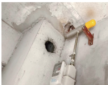
整改后,仅剩一小节燃气管道裸露在厨房。
