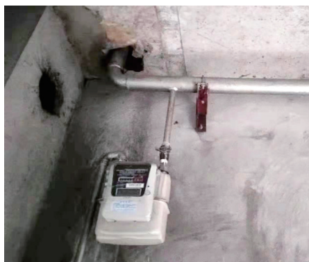
整改前,业主认为裸露的燃气管道从厨房和阳台穿过,存在安全隐患。
