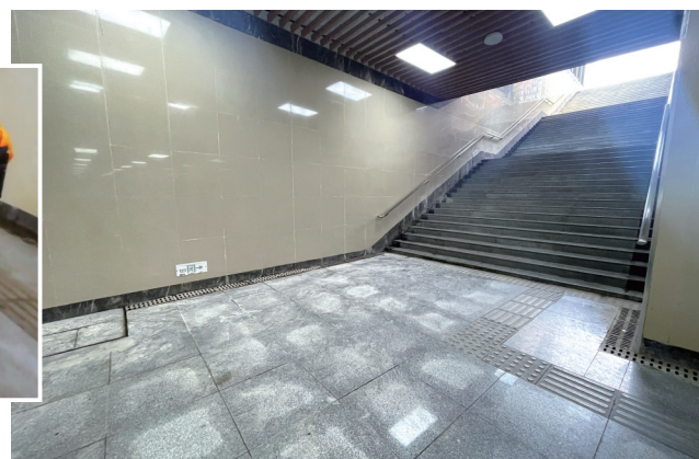
地下通道的积水基本被清理。
