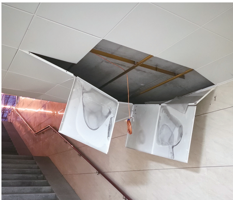
天花板脱落十分明显。
