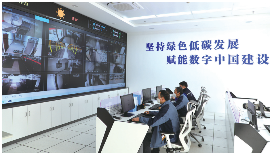
工作人员对机房各项数据进行监测。
