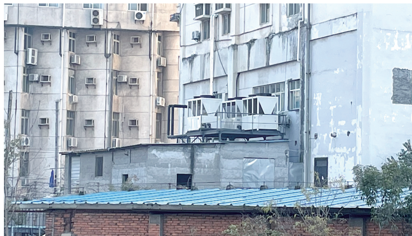
车城金都小区外侧矮房顶上的3台供暖设备一运行,就嗡嗡作响。
