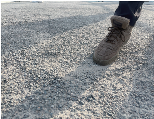
桥面破损坑洼的情况非常明显。
