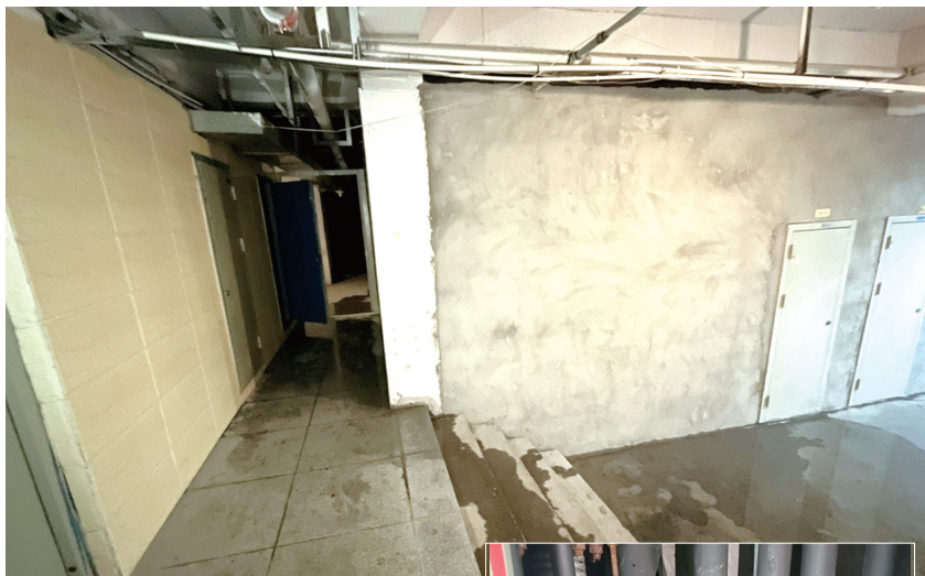
负二楼暖气井里的水已经漫到地面。
