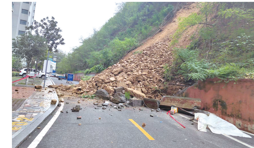
滑坡体占据了整个消防通道。
