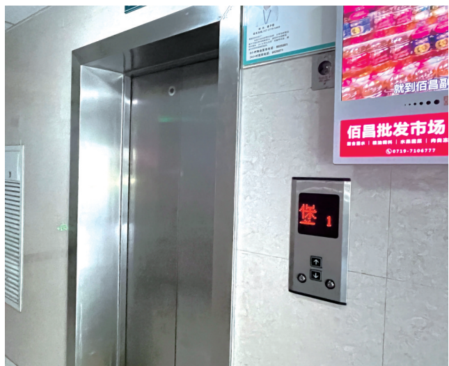
这部电梯处于停运中。
