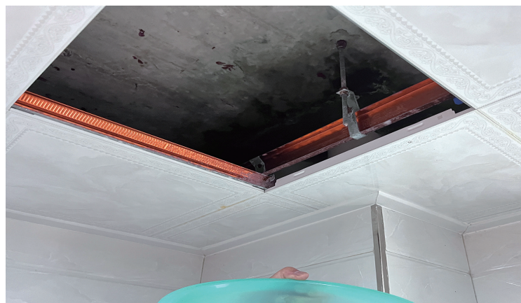
卫生间天花板处因漏水,导致整个墙面都有水渍。
