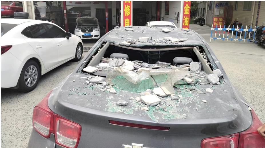
外墙的瓷砖脱落,砸中了楼下停放的车辆。
